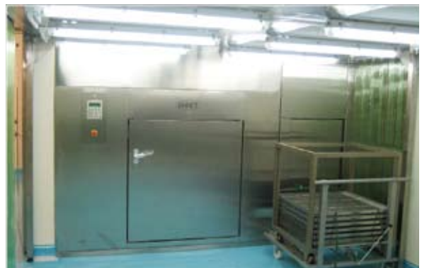
圖三、除熱原烘箱（Depyrogenation oven）。
